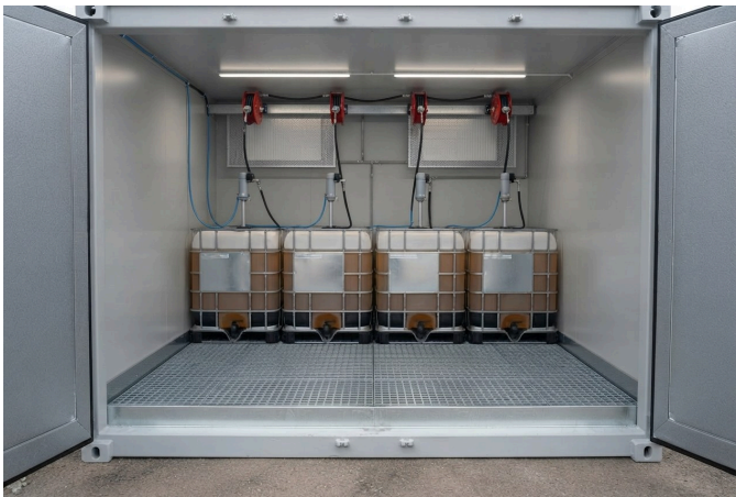
Насосы в горловинах кубов, катушки под потолком
